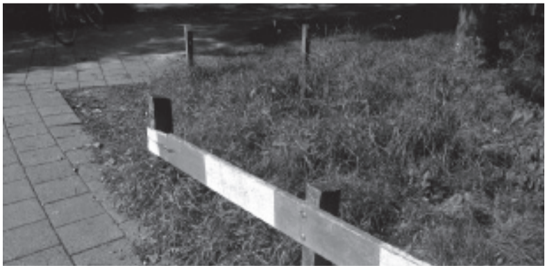
Onder: Dit schrikhek is bij het witte bruggetje bij de Reestoeverschool. De plank is los en om de hoek is de plak helemaal weg.
